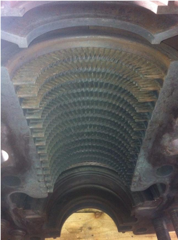
ROTOR TURBINA 2 ANTES LIMPIEZA
